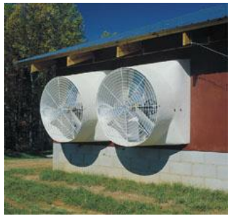
صور توضح تركيب مراوح التهوية في الجدار الخارجي
