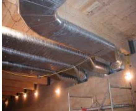
صور توضح شكل المجاري الهوائية (Grille) من الداخل (تحت الأسقف حيث يتم بعد ذلك تغطيتها بالأسقف المستعارة)
