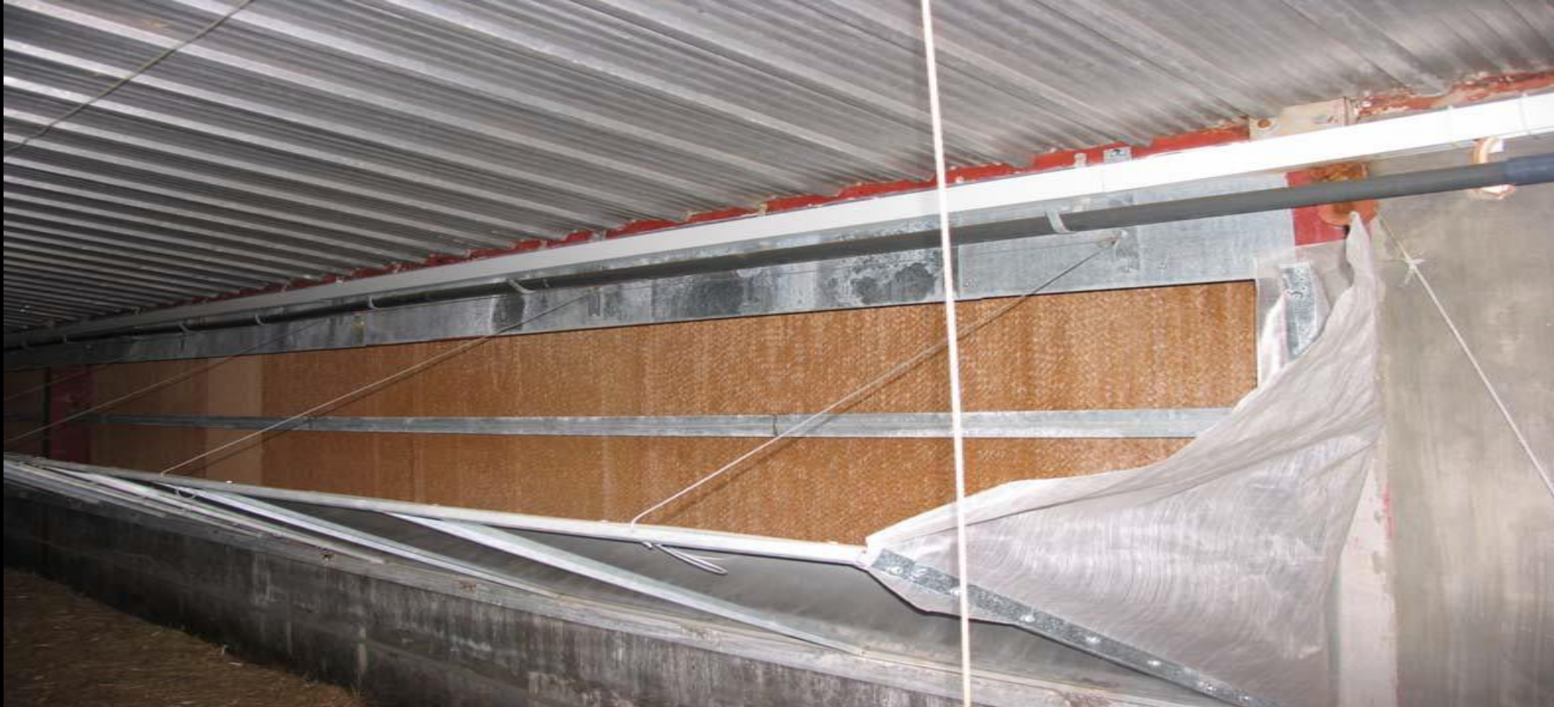
شكل موجّهات الهواء البارد داخل المسكن Air deflectors
